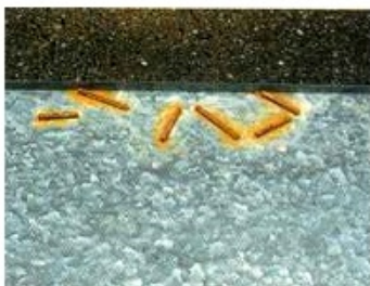
Abb. 4: Reste von Schweißelektroden können sog. "Fremdrost" verursachen
