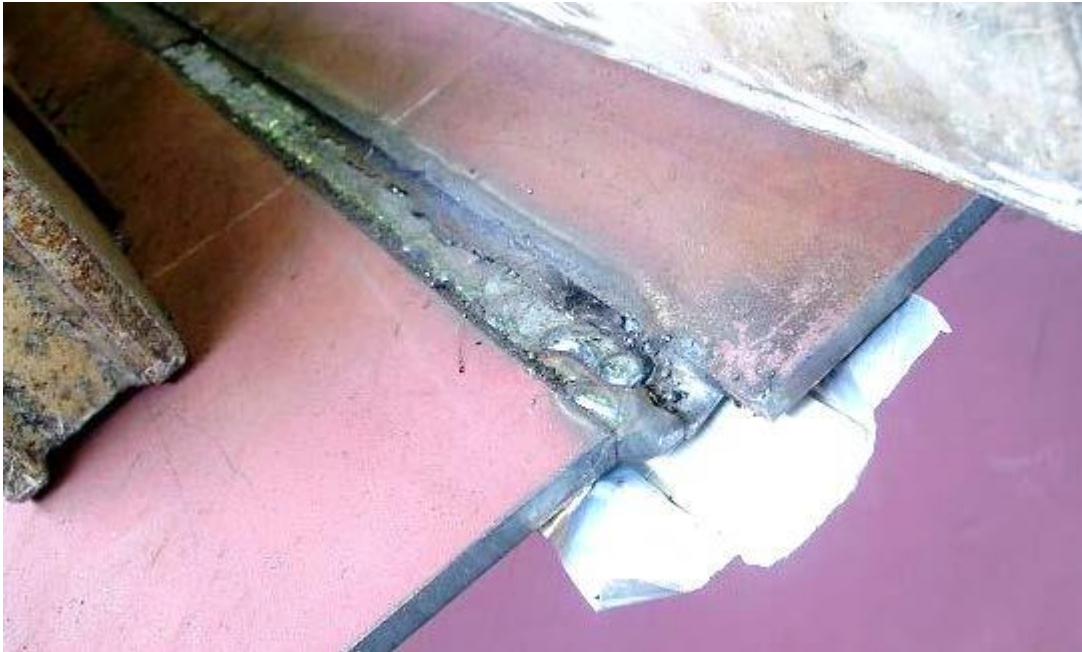
Bild 4. Sichtprüfung während des Schweißens, Riss in Zwischenlage
