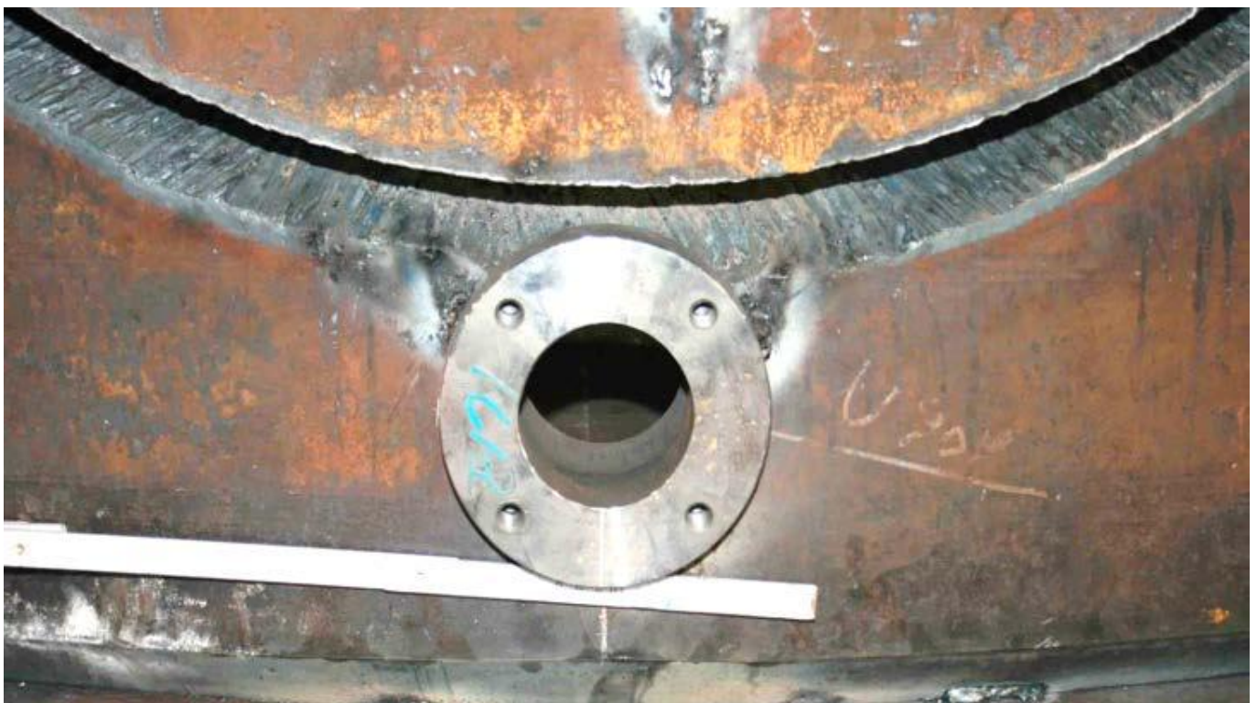
Bild 3: Nahtvorbereitung mangelhaft, Schweiß- und Zusammenbaufolge nicht beachtet.
