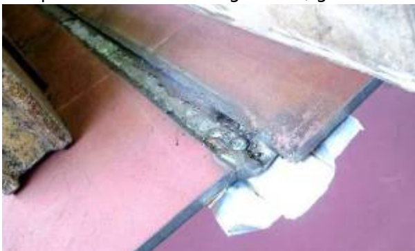
Bild 4: Sichtprüfung während des Schweißens, Riss in
