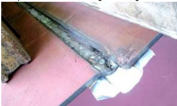
Bild 4: Sichtprüfung während des Schweißens, Riss in
