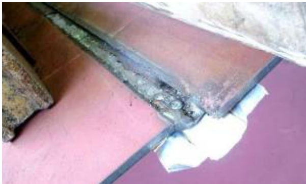
Bild 4: Sichtprüfung während des Schweißens, Riss in
