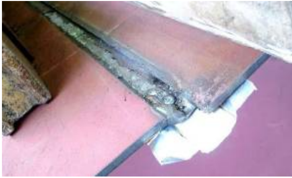
Bild 4: Sichtprüfung während des Schweißens, Riss in
